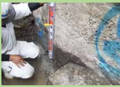
空隙が入っており、耐久力が不足しているコンクリート
