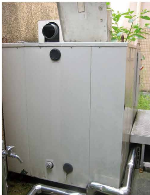
▲生ゴミ処理機（日栄小学校）
