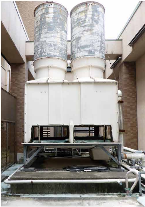
▲エアコン室外機（豊日中学校）
