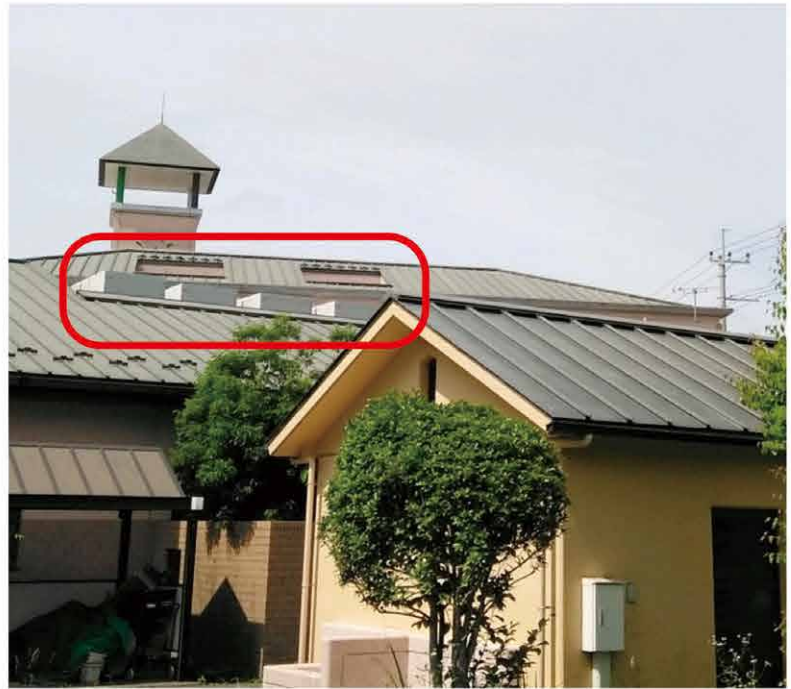
▲エアコン室外機（日栄のさと）
